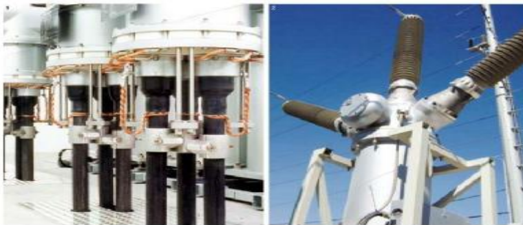
Figura 2.9 Modulo de conexiones de cables y terminales SF 6 -Aire
