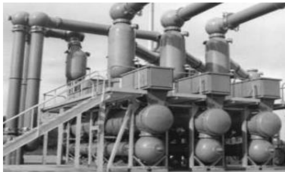
Figura 2.1 Primera Subestación GIS de 800 kV (Sistema de American Electric Power (USA))
