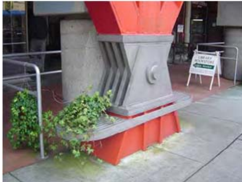
Fig. 2.18 Detalle de la base del edificio de la foto anterior (los pernos están sometidos a corte)
