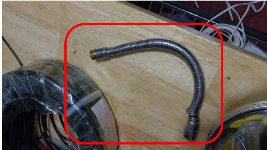
Fig. 2.4 Tubo flexible utilizado como soporte, presenta daños en un extremo.
